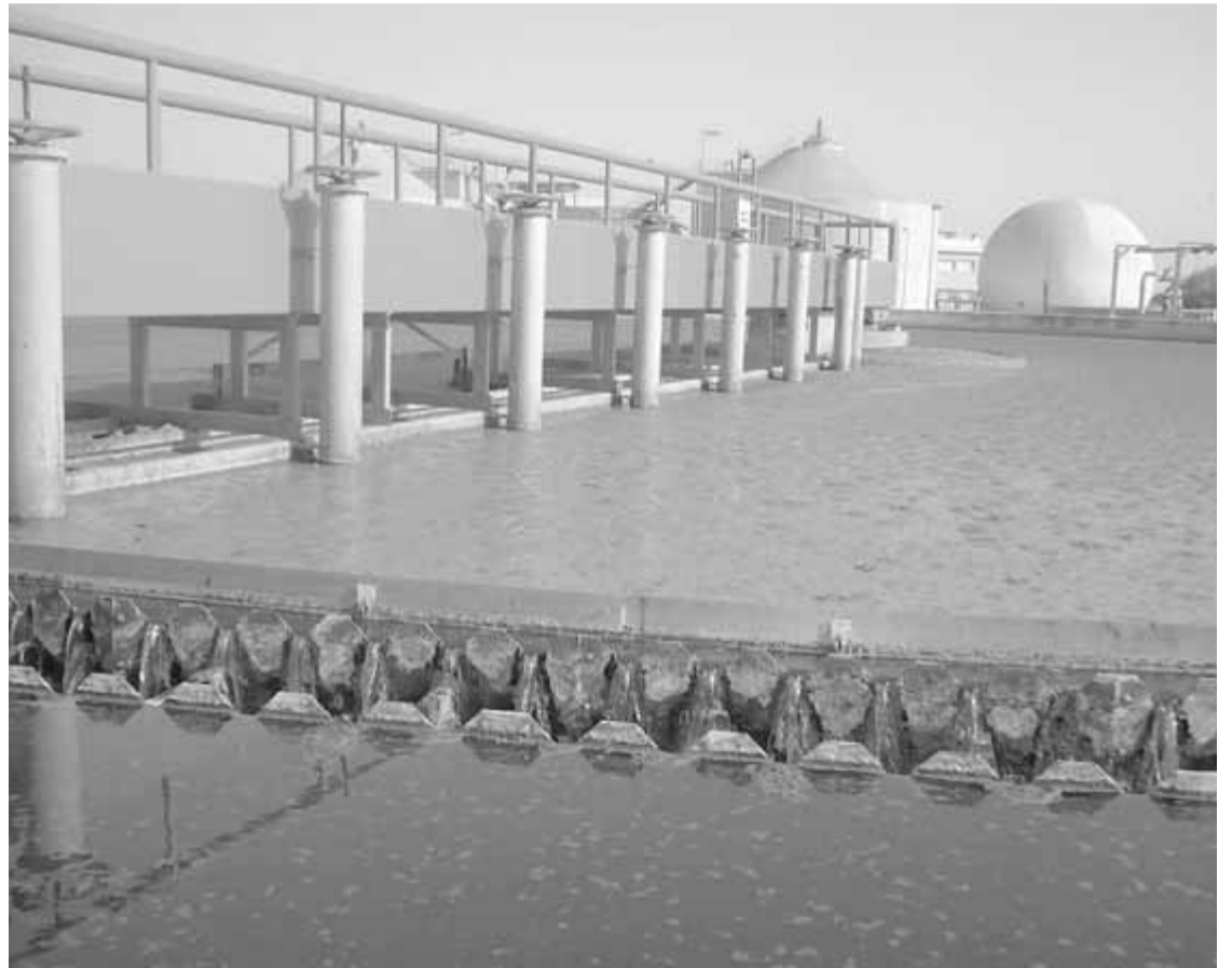
Imatge de les instal·lacions de depuració d'aigües residuals de Mataró (Maresme). ARXIU
