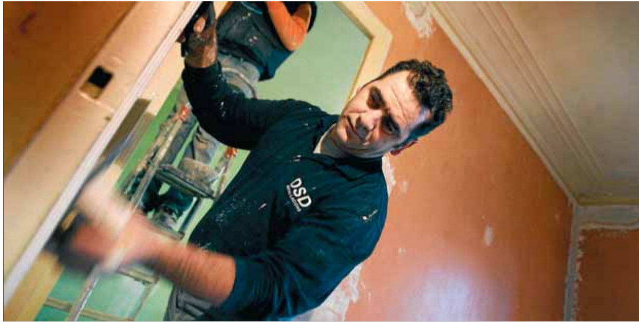
Mihita, un treballador de la construcció d'origen romanès, treballant en la rehabilitació d'una casa ■ FRANCESC MELCION / ARXIU
