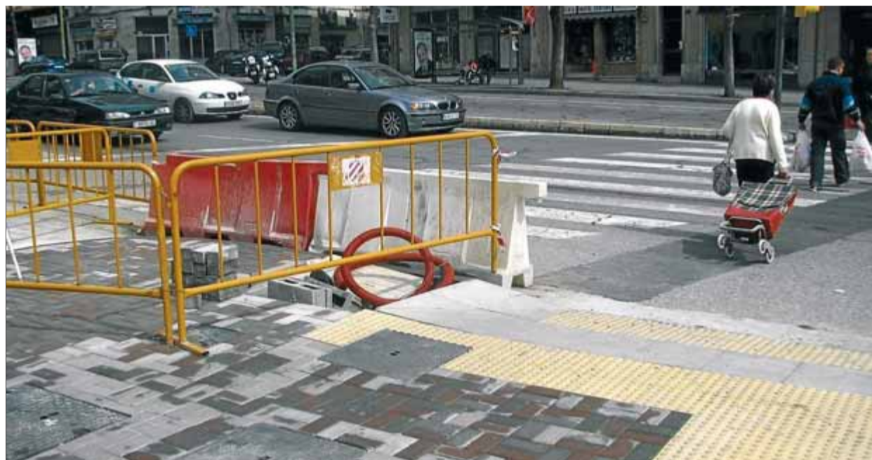
Llambordes defectuoses a Ronda, un altre inconvenient que ha obligat a substituir paviment ja col·locat ■ ACN
