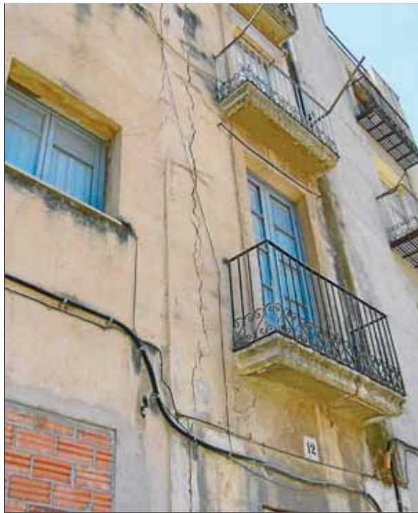
Un edifici amb una doble esquerda a la façana ■ L.M.
