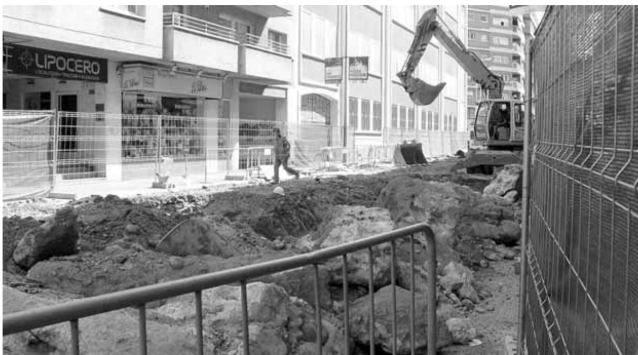
El carrer Migdia obert per les obres que permetran reurbanitzar-lo i refer tot el clavegueram ■ D.V.
