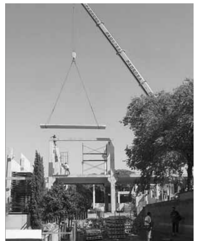
Les obres de la sala polivalent s'estan fent entre el pavelló esportiu i l'escola ■ M.V.
