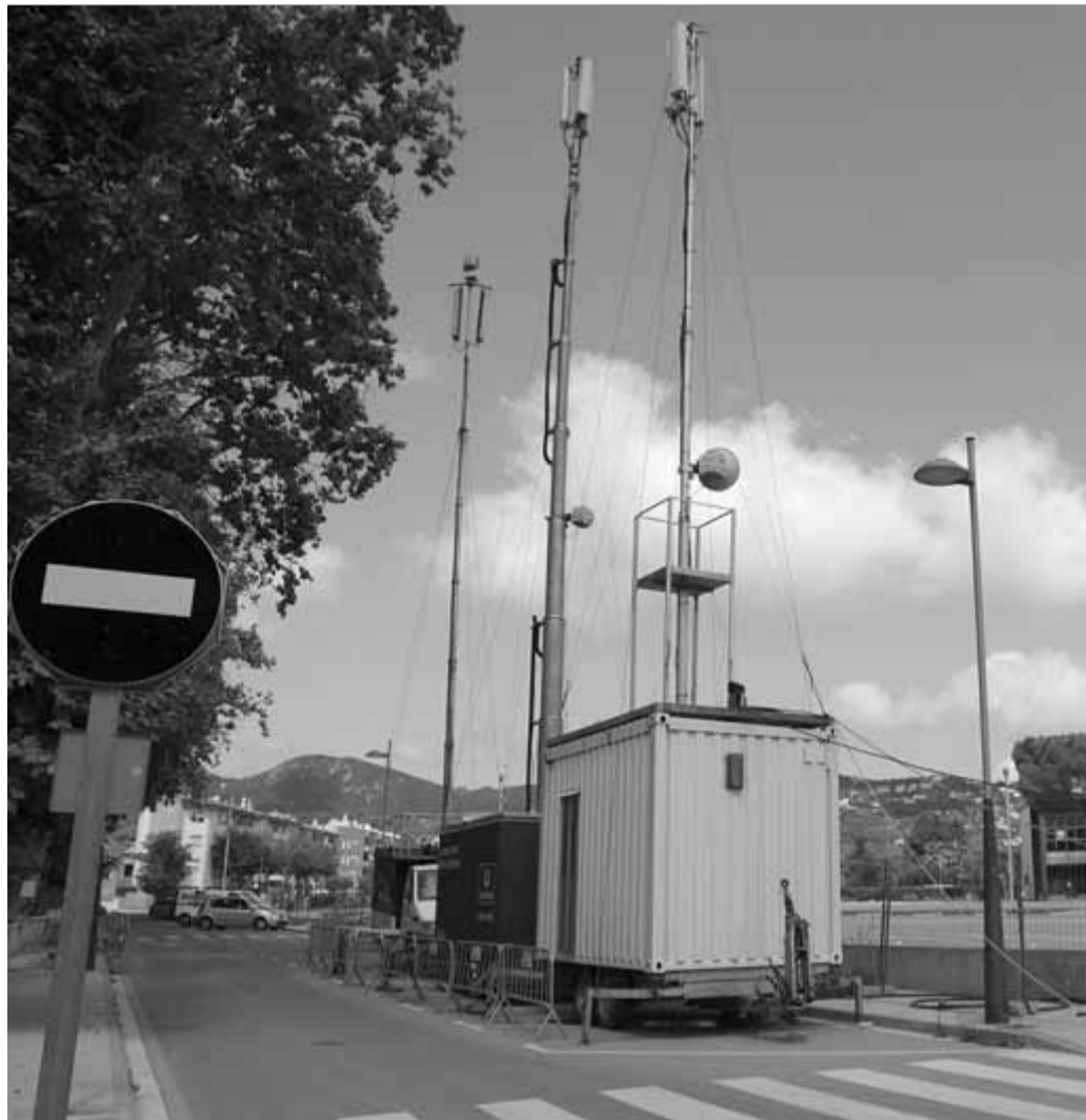
Antenes de telefonia, instal·lades provisionalment fa quatre anys a Santa Cristina ■ JOAN SABATER
