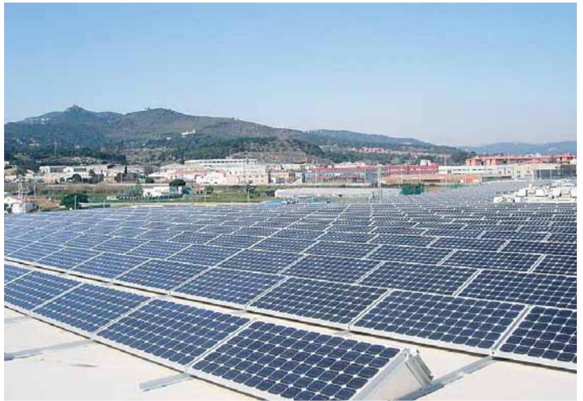
Planta fotovoltaica del Centre Integral de Valorització de Residus del Maresme, a Mataró. ARXIU
