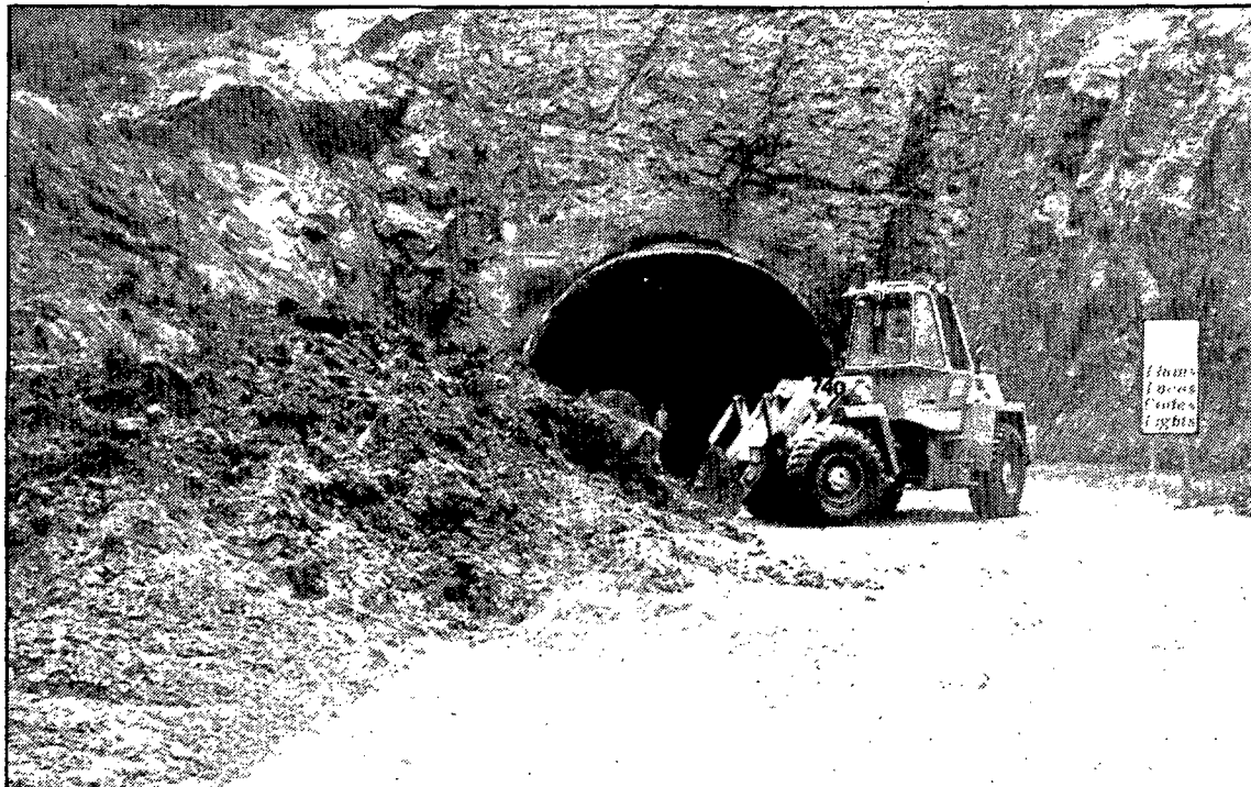
Part del tram nou de la carretera del túnel d'en Bas s'ha esllavissat. (Foto JULI).
