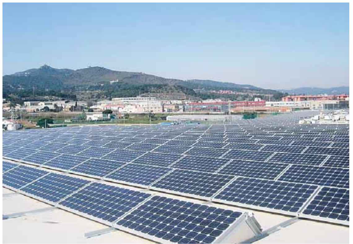
Planta fotovoltaica del Centre Integral de Valorització de Residus del Maresme, a Mataró. ARXIU
