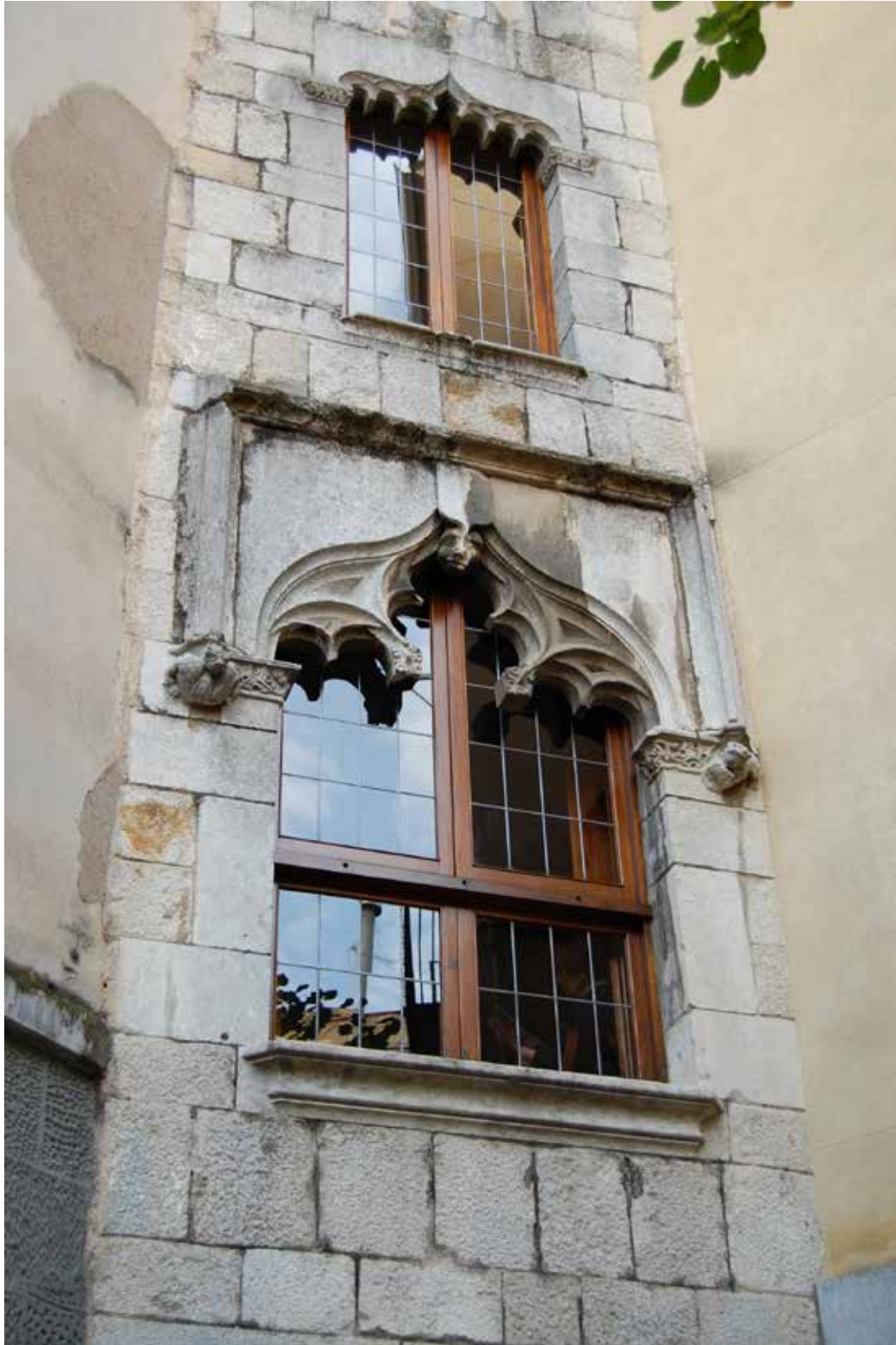
Fig. 17. Detall d'una de les façanes del que havia estat la plaça del Mercadal. Les dues finestres coronades amb arcs conopials daten del segle XV i representen un dels pocs exemples d'arquitectura civil medieval que es conserven en el Mercadal.
