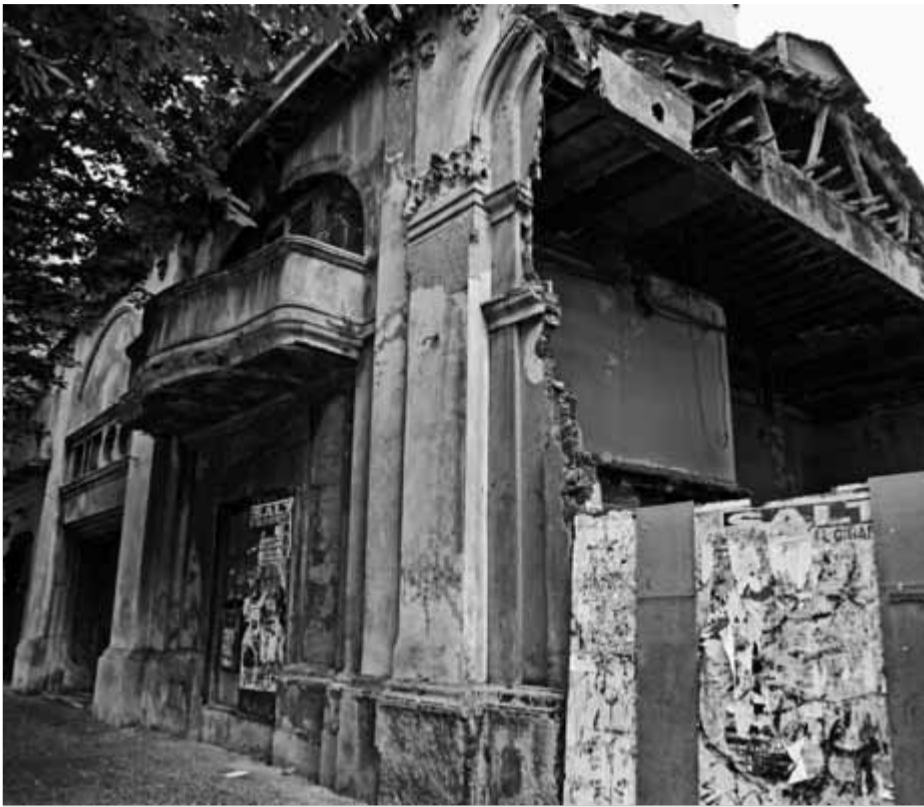
El mal estat de l'edifici de l'antic bingo a la Gran Via de Girona ■ JOAN SABATER
