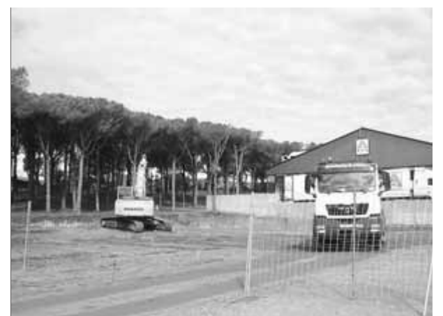
Obres de construcció de la nova gasolinera de Palafrugell, que serà de Repsol ■ A.V.
